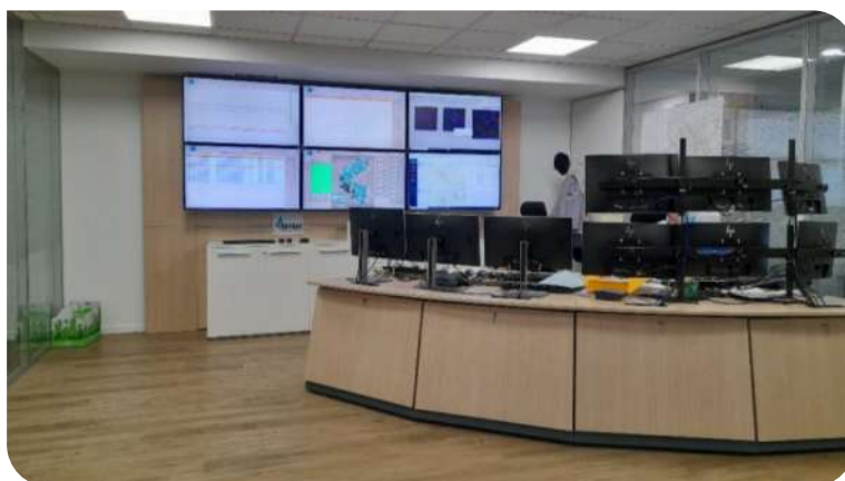
Figure 12 : Poste de contrôle GAIA dans les locaux de Suresnes
