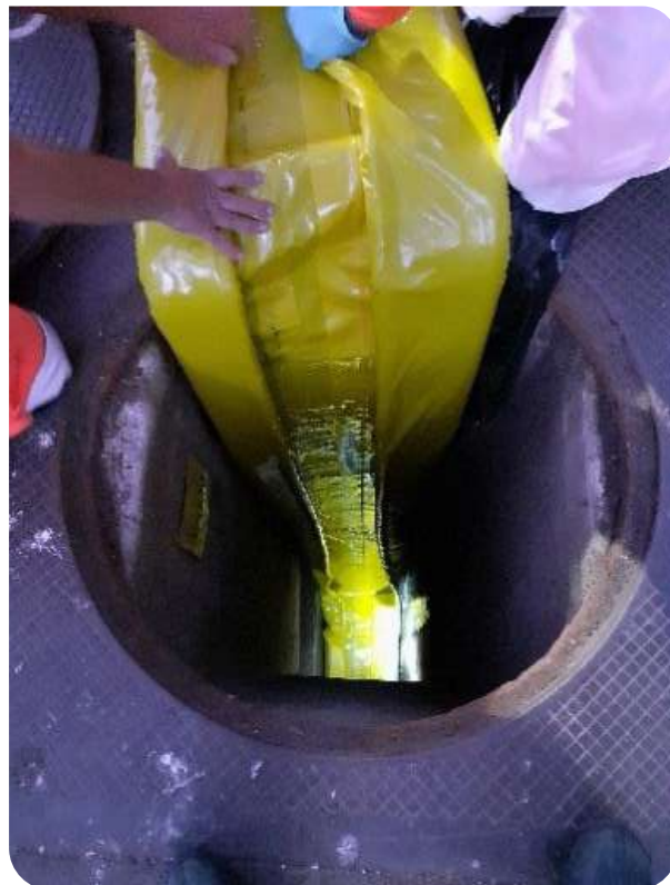
Figure 22 : Mise en place du chemisage et préparation du train de lampes UV rue Aristide Briand à Issy-Les-Moulineaux
